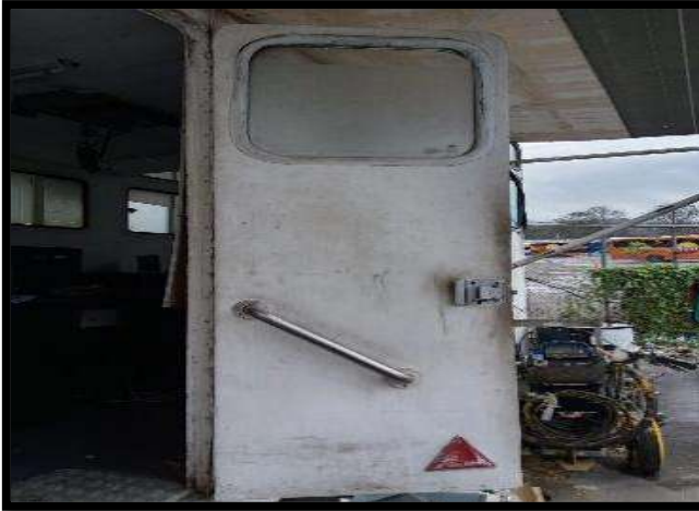
Ilustración 25: Estado de instalaciones recibidas
