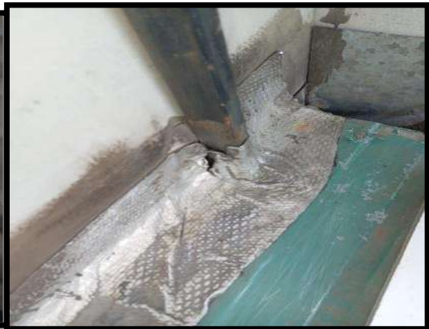
Ilustración 28: Estado de instalaciones recibidas
