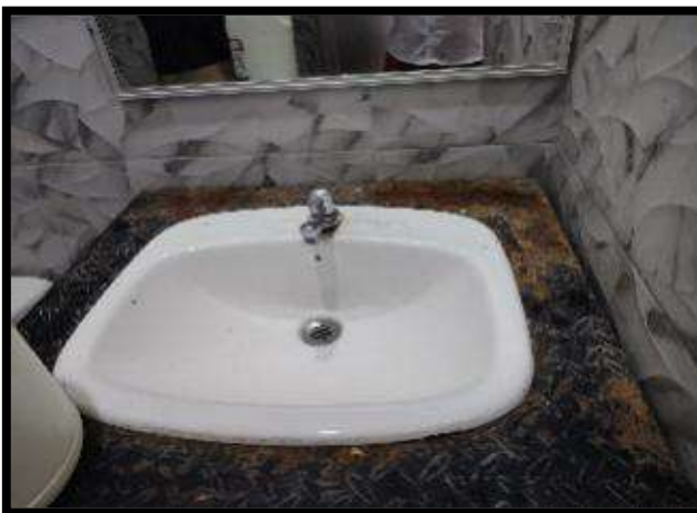
Ilustración 27: Estado de instalaciones recibidas
