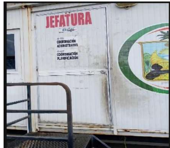
Ilustración 24: Estado de Instalaciones recibidas
