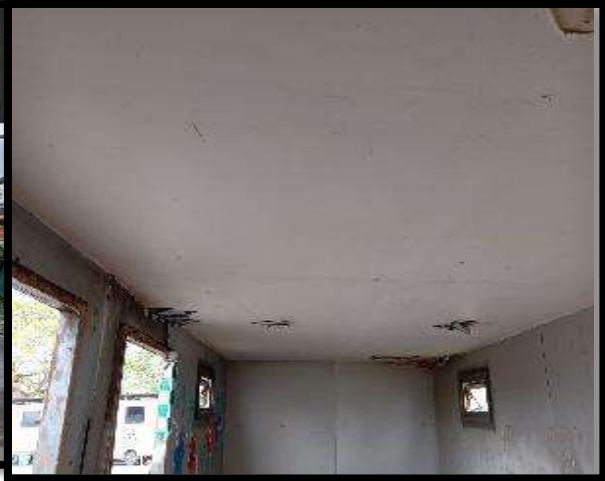
Ilustración 26: Estado de instalaciones recibidas
